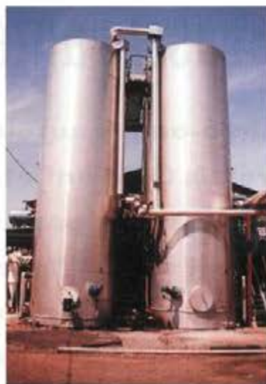
Cuvées de stockage sur le site d'Hydrocar, à Flawinne
